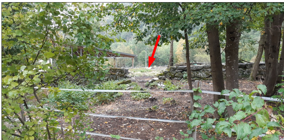
Figure V.20: Brèche ouverte dans l'épi au droit du centre équestre de Bonvoisin.
