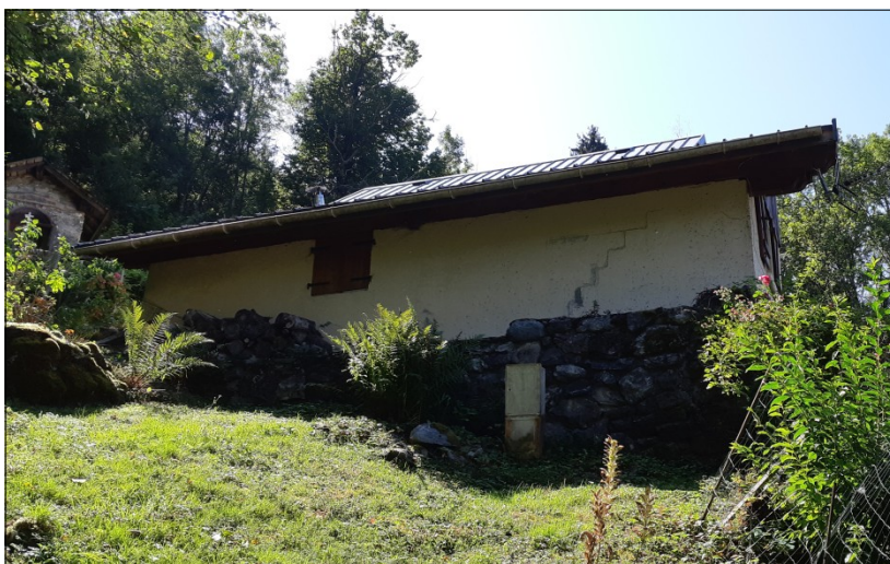
Figure V.10: Tassement différentiel caractéristique d'un glissement actif au Champ-Fleury-d'en-Haut
