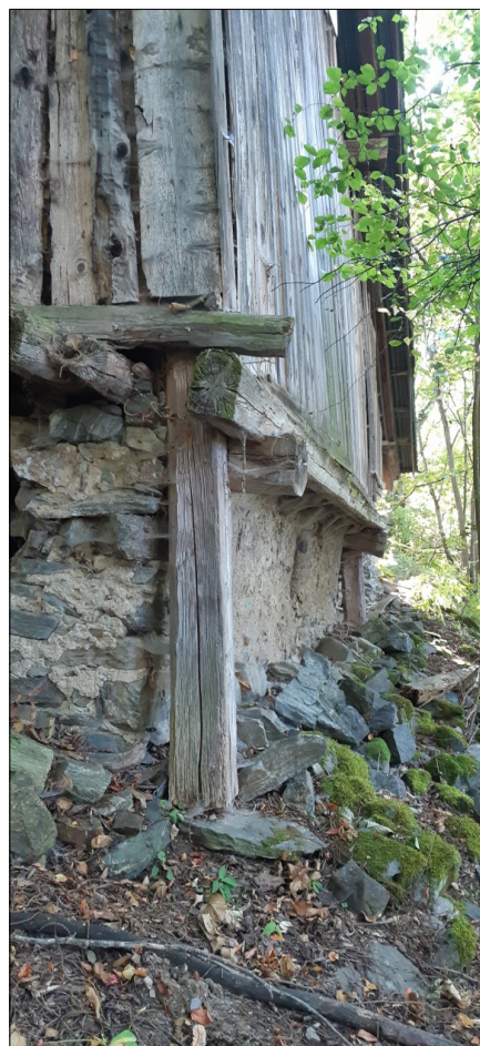
Figure V.9: Soubassement d'un chalet déformé par le glissement de terrain au Pinais-d'en-Bas.
