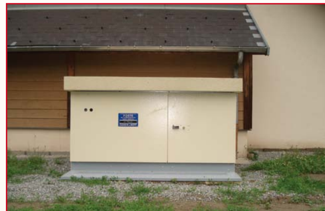
Le nouveau poste de La Pallud
